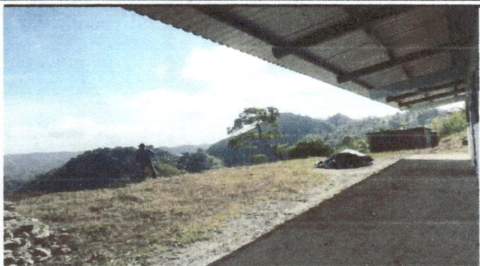
Foto 1: EN LA SIGUIENTE FOTOGRAFIA, SE PUEDE OBSERVAR QUE SEA DE URGENCIA LA COLOCACION DEL CORREDOR Y ENTECHADO DE 5*17 M2
