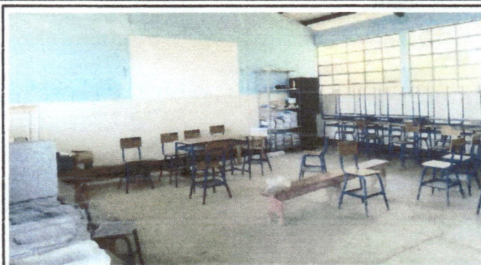
Foto 2: EN LA SIGUIENTE FOTOGRAFIA SE NECESITA EL CAMBIO DE PISO, DE PREFERENCIA AZULEJO, TAL COMO SE DETALLA EN LA SOLICITUD.
